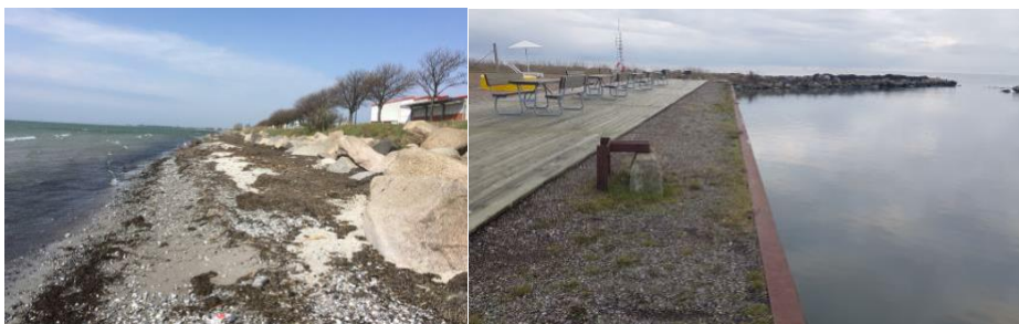
Figur 96. Bild vänster: Befintligt erosionsskydd (stenskonung) i östra verksamhetsområdet. Bild höger: Artificiella strukturer vis småbåtshamnen.
