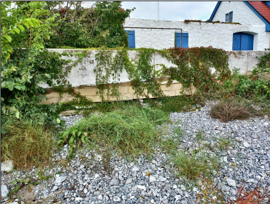
Figur 4-2 Bostadshus i östra Smygehamn. Muren har underminerats av erosion och riskerar att rasa.
