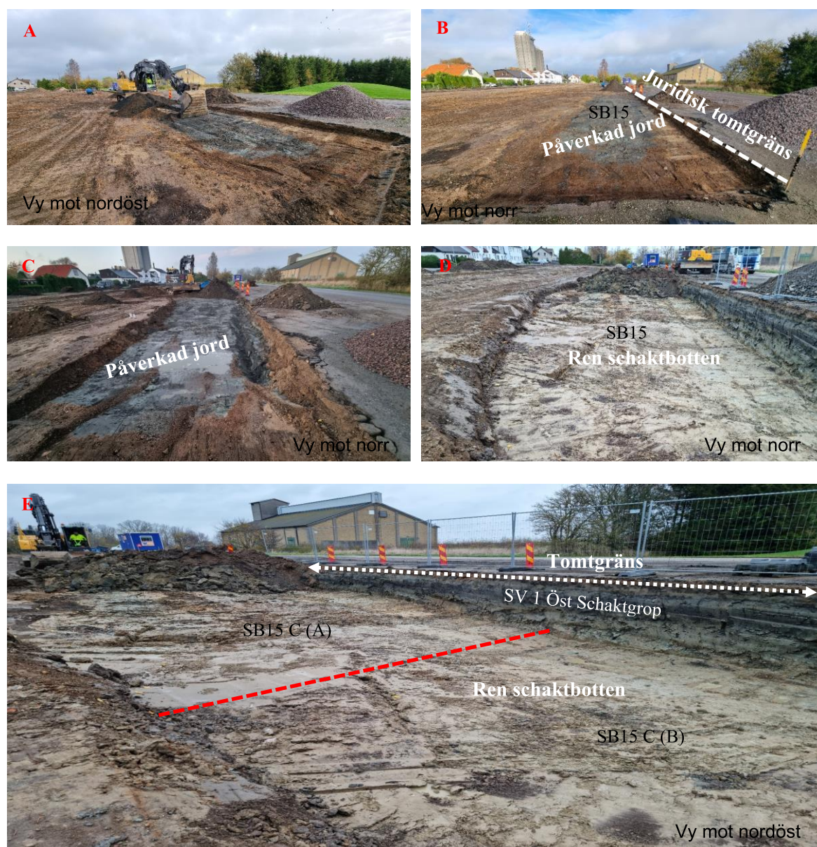
Figur 5.1-A-B , visar pågående urschaktning av mark inom den östra delen av fastigheten 7:137. Samtliga massor påverkade av "olja" och arsenik har körts bort.
