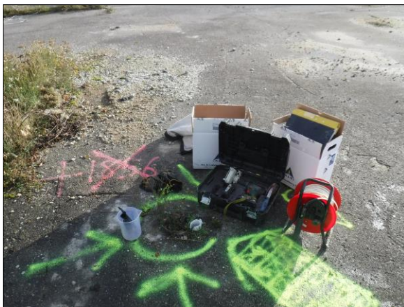
Figur 8. Provtagning av grundvattenrör med peristaltisk pump.
