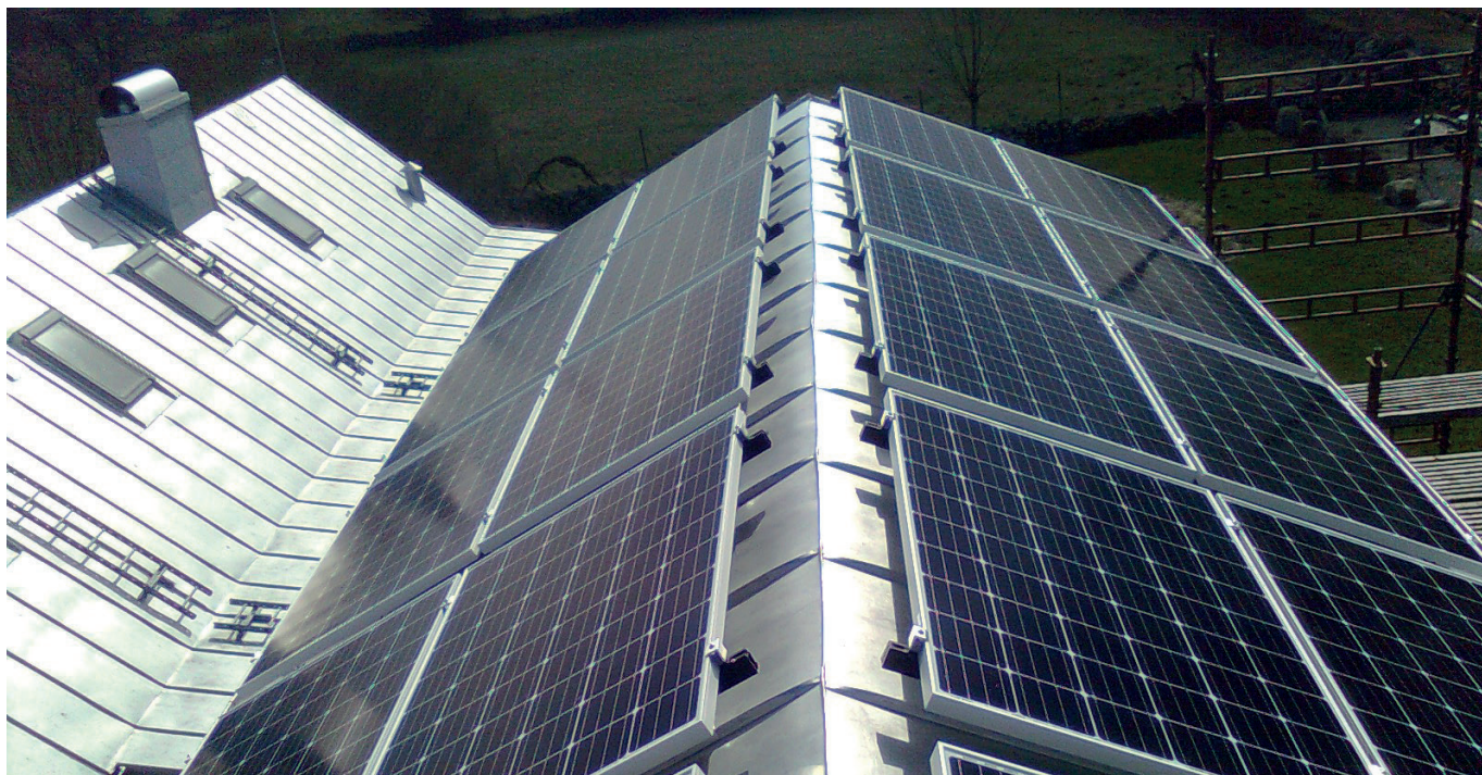
Exempel på anläggning med svag taklutning i ett öst-västläge.
