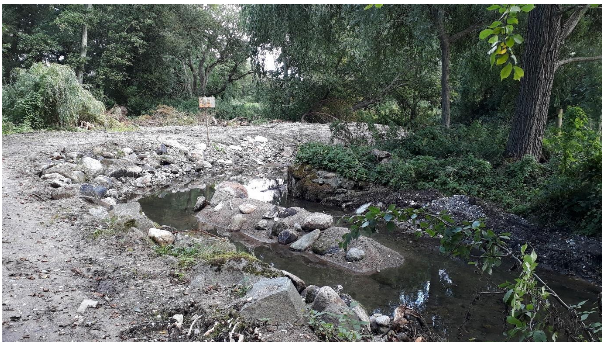
Figur 14. Dalköpingeån efter åtgärd vid fallet sommaren år 2020. Åtgärder vid vattendrag kan vid anläggningskedet orsaka erosion och ökad transport av näringsämnen (Foto SYNLAB).
